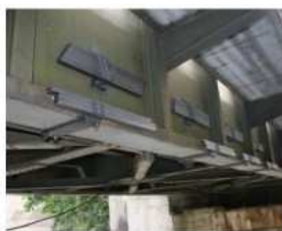
absorbeur sur platelage
