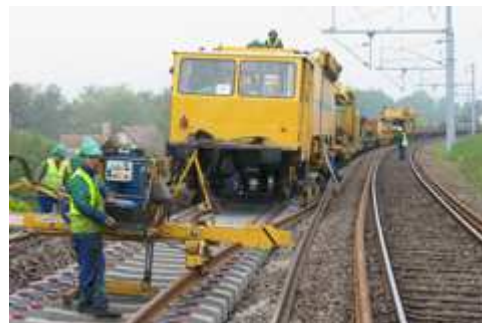
Longs Rails soudés sur traverses béton
